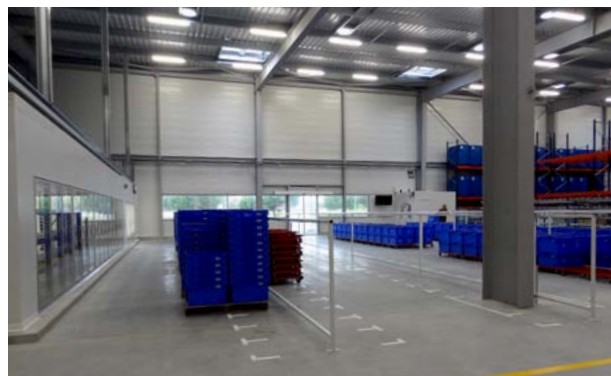
Éclairage de locaux de travail avec vue sur l'aire de livraison
