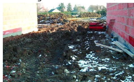
Piste dégradée sur chantier voisin
