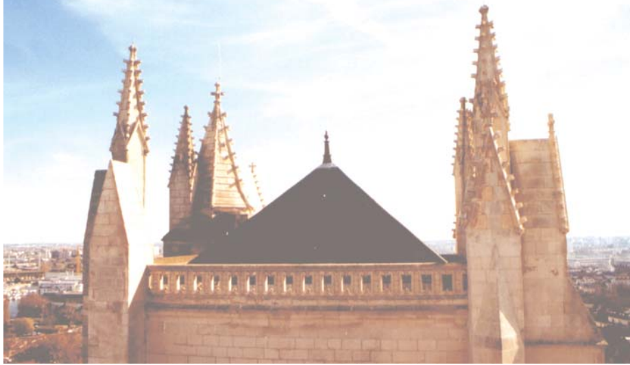
Garde-corps avec main-courante, en bas de pente de la couverture des tours.
